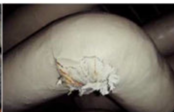
エルボ部に使用 石綿含有保温材
