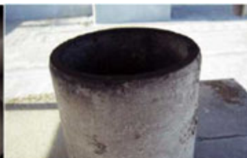
煙突の内側に使用 石綿含有断熱材
