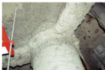
柱や梁に施工 吹付け石綿
